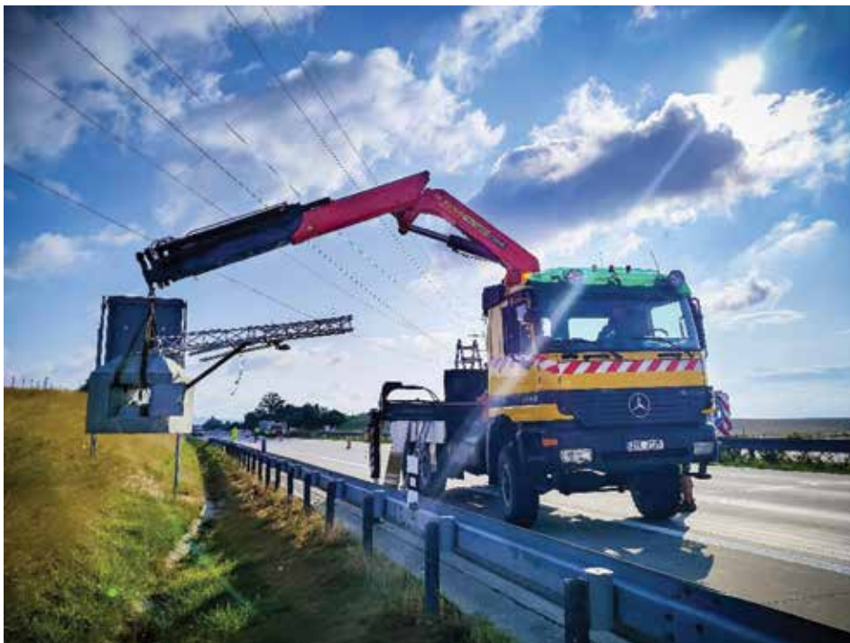
Obř. 2: Instalace přenosného detekčního a kamerového systému
