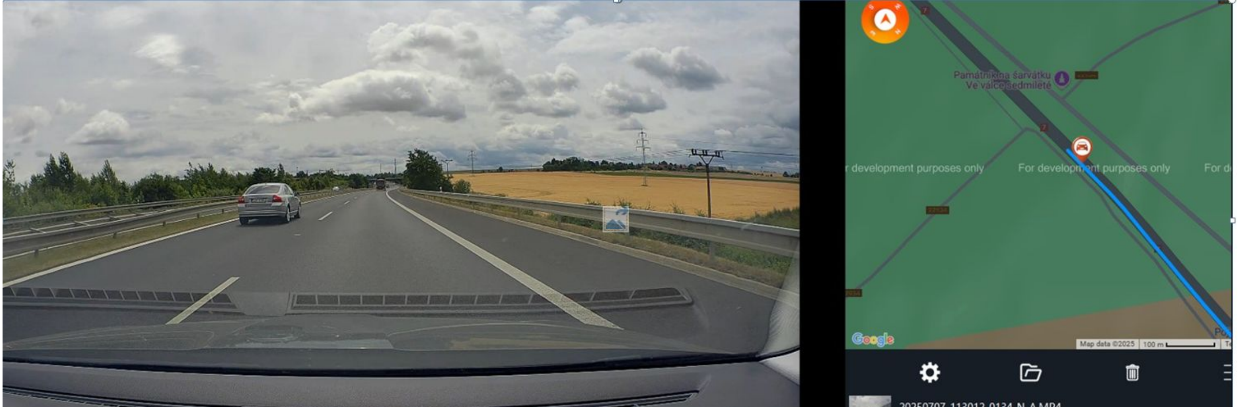
Dálnice D7 – poškozené středové svodidlo
