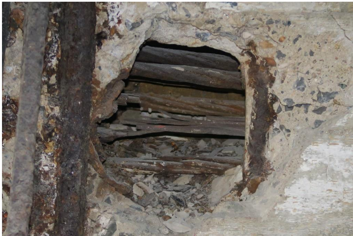
Koroze a poškození stávajících soudržných kabelů
