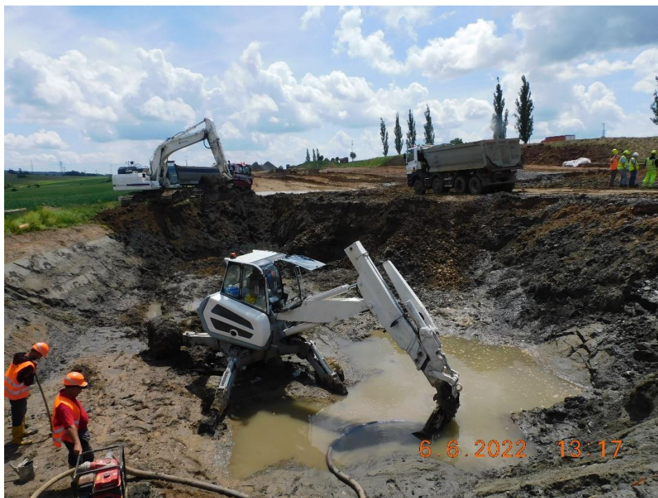
Obr. 1 Písecká přechodová oblast mostu SO 201 úsek Milín – Lety (výměna neúnosného podloží: obsah 17,7% organiky v sedimentech)
