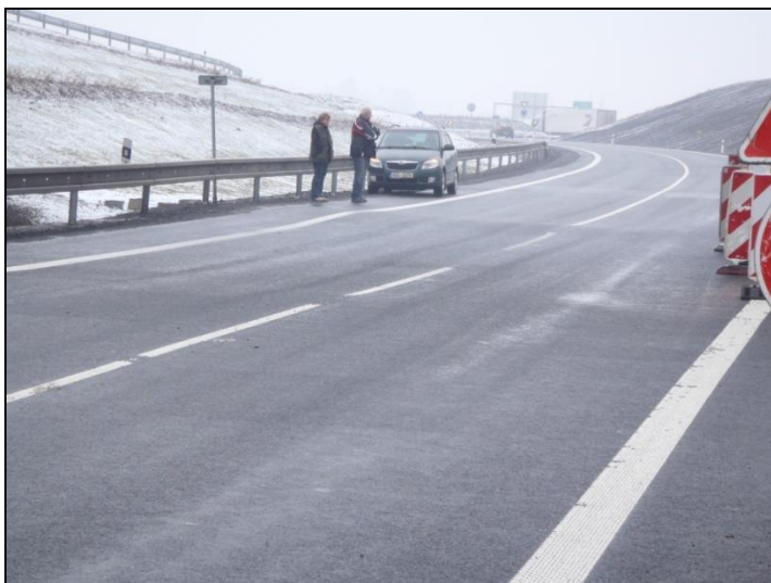
Silnice I/56 Příbor – obchvat, deformace vozovky způsobené objemovými změnami eluviálních jíílů (11/2011)
